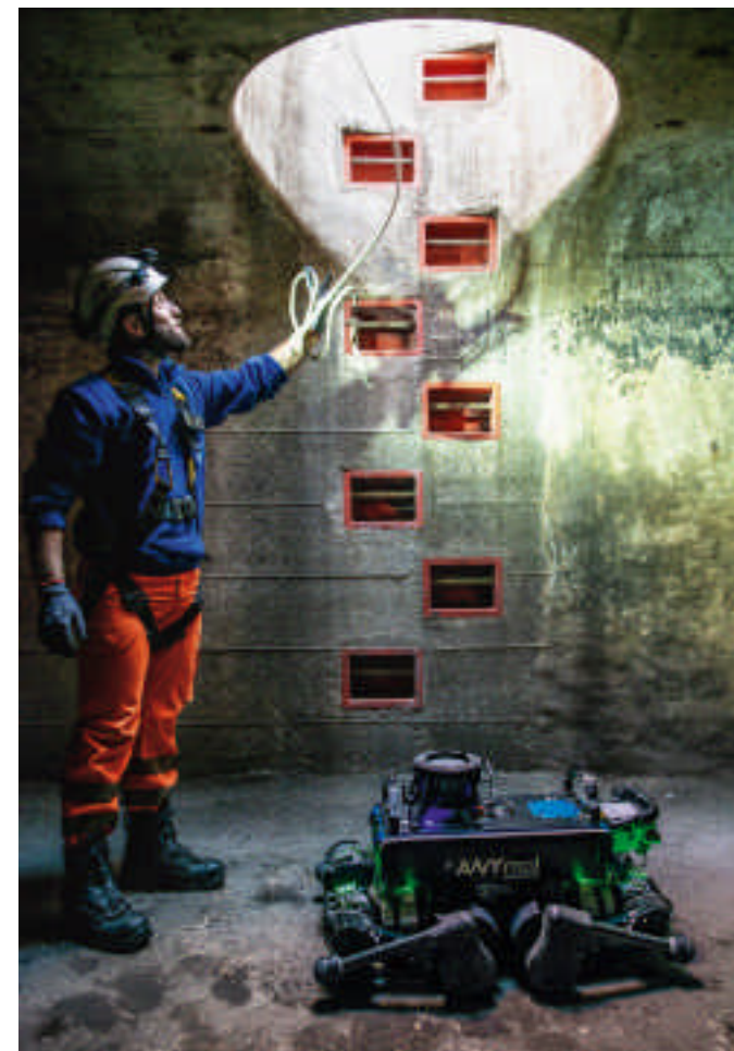
Anymal ist heil am Grund des Schachts gelandet.
